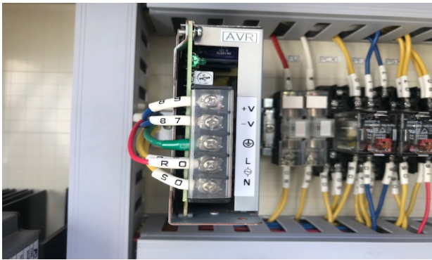
AVR(直流電源装置)交換前
