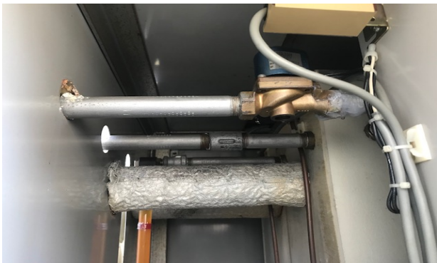
給水配管水漏れ
