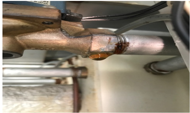
給水配管水漏れ(拡大)
